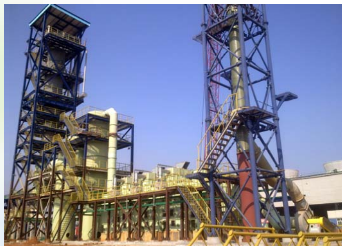
从左至右，焚烧炉，急冷塔，文丘里洗涤塔，冷凝器，IWS™ 电离湿式洗涤塔，排气筒。
